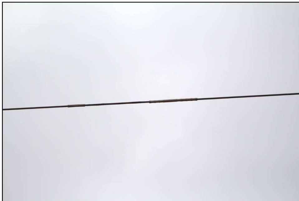
Фотографија 10: Место где је жица далековода оштећена
